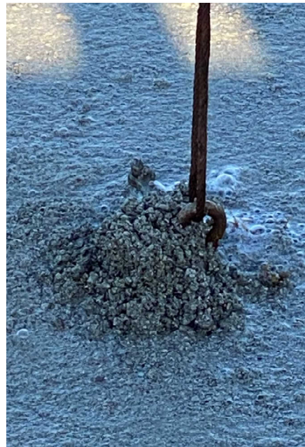
ポンプ作動状況
