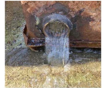
排水フィルター (内側3重)
