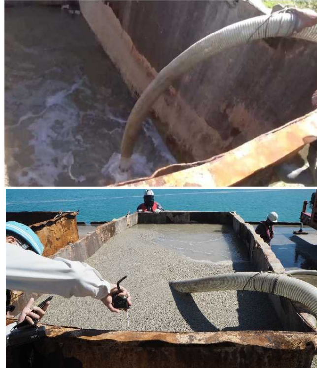
タンクコンテナ内の回収状況
