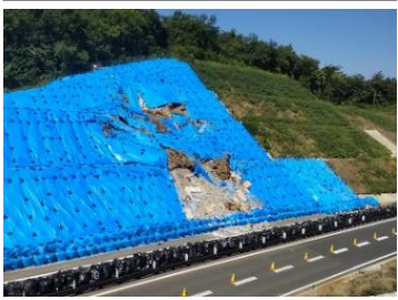
写真① 法面崩壊状況
