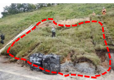
写真② 法面の孕みだし
