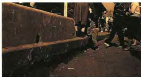
地盤沈下によって陥没した道路 (大阪市水道局蔵)
