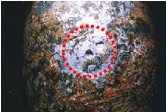
写真 2-07 : 劣化度判定 『b』
