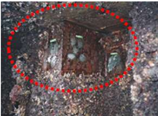
写真 1-07 : 劣化度判定 『b』
