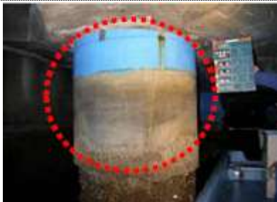
写真 3-01：劣化度判定『a』
