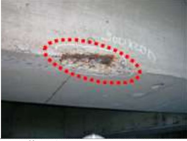
写真 1-14 : 劣化度判定 『a』
