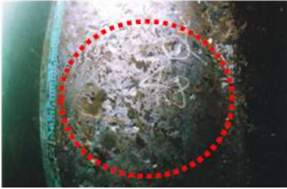
写真 2-05 : 劣化度判定 『b』
