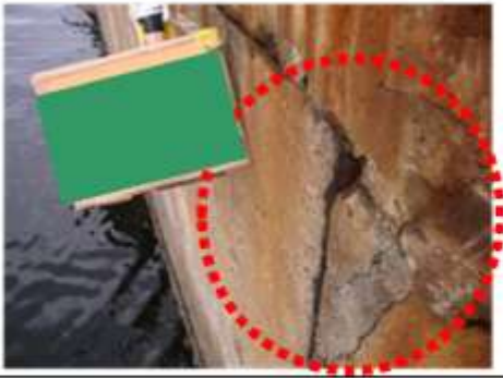
写真 4-03：劣化度判定『b』
