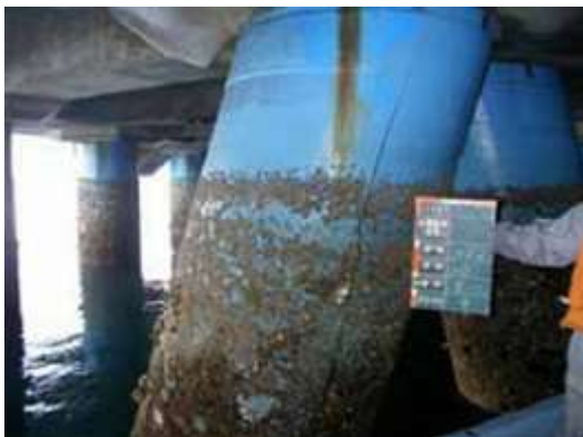
写真 3-11 : 劣化度判定 『b』
