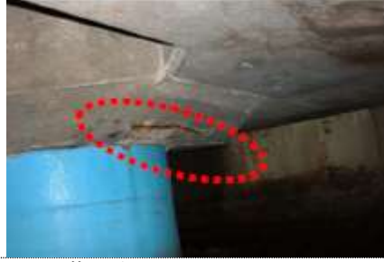
写真 1-15 : 劣化度判定 『a』
