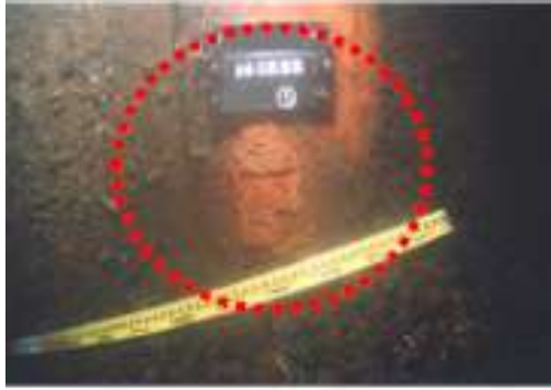
写真 1-05 : 劣化度判定 『b』
