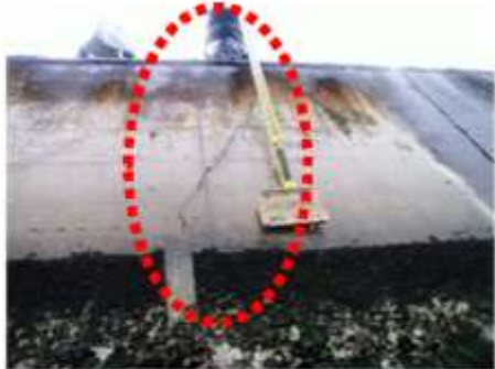
写真 4-04：劣化度判定『b』
