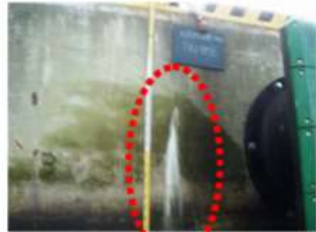
写真 4-12 : 劣化度判定『c』
