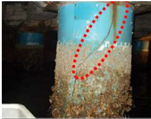
写真 3-09 : 劣化度判定 『b』
