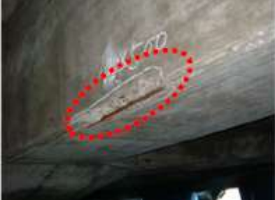
写真 1-16 : 劣化度判定 『a』
