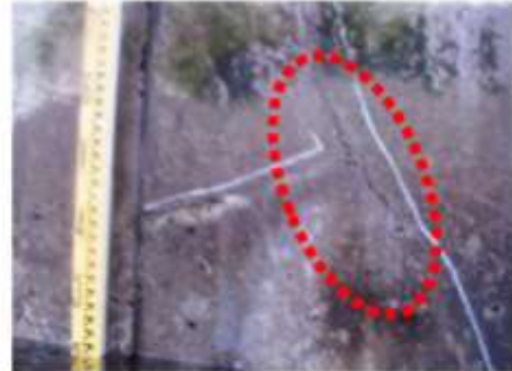
写真 4-14 : 劣化度判定『c』
