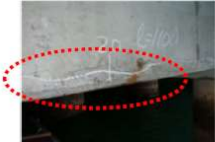
写真 1-18 : 劣化度判定 『b』
