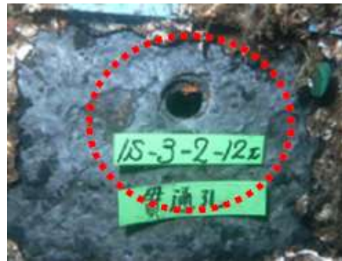
写真 2-02：劣化度判定『a』
