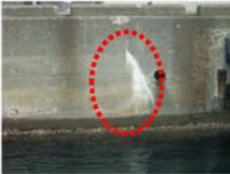
写真 4-13 : 劣化度判定『c』
