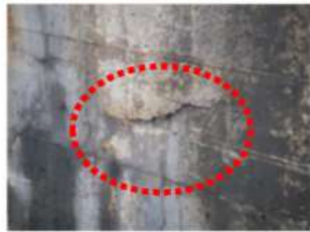
写真 4-02：劣化度判定『b』
