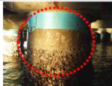
写真 3-02：劣化度判定『a』
