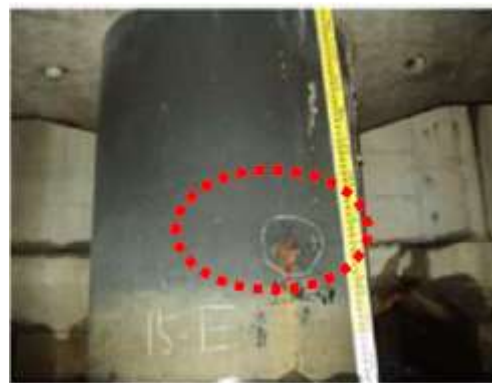
写真 3-10 : 劣化度判定 『b』
