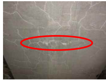
貫通ひびわれあり
