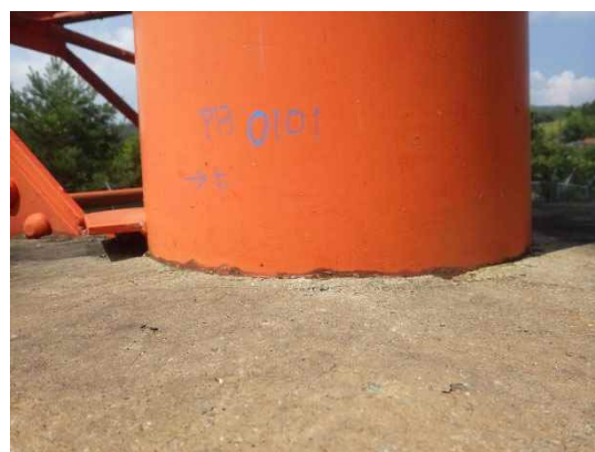
基部腐食 例(軽微)
