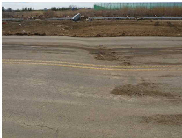
写真 4.3.3 大規模地震に伴う誘導路の沈下状況（例）
