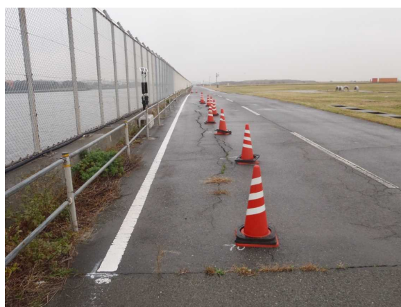
写真 4.3.2 場周道路の二次災害防止状況（例）
