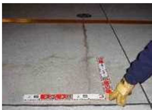
写真 3.1.17 ひび割れ（横断方向）
