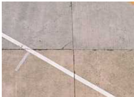
写真 3.1.16 ひび割れ（隅角部）
