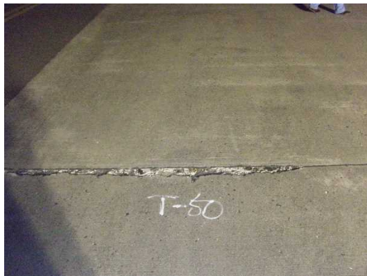
写真 3.1.23 目地部の破損
