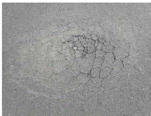
写真 3.1.3 亀甲状ひび割れ
