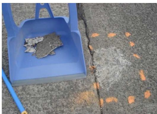
写真 3.1.22 剥がれ（スケーリング）
