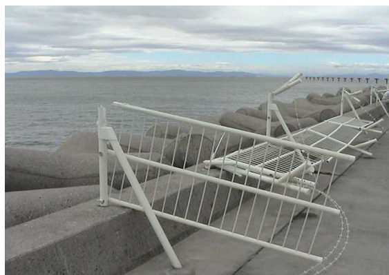
写真 4.3.1 災害に伴う施設破損状況（例）
