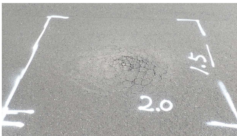
写真 4.2.6 点検記録写真（ひび割れ撮影例）
