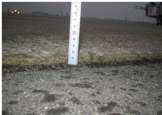
写真 3.1.25 コンクリート版の持ち上がり
