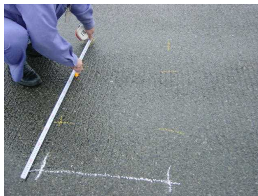
写真 3.1.10 路面のすり減り
