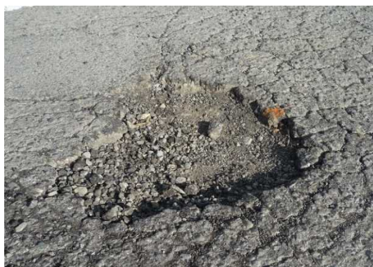
写真3.1.8 ポットホール
