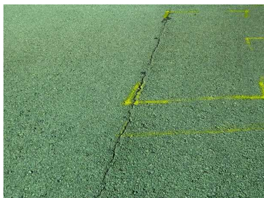
写真 3.1.4 施工目地の開き
