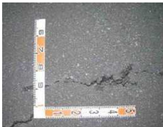
写真 3.1.2 線状ひび割れ
