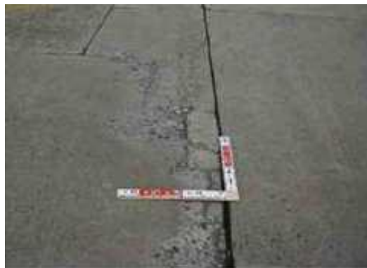
写真 3.1.20 座屈（ブローアップ）
