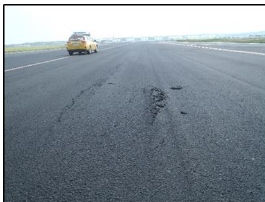
図-3-2 舗装内部の変状に起因する舗装面破損
