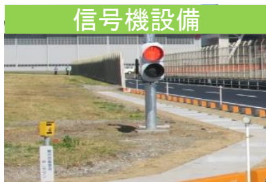
空港制限区域内の信号機設備の例
