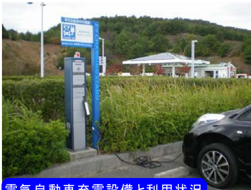
電気自動車充電設備と利用状況
