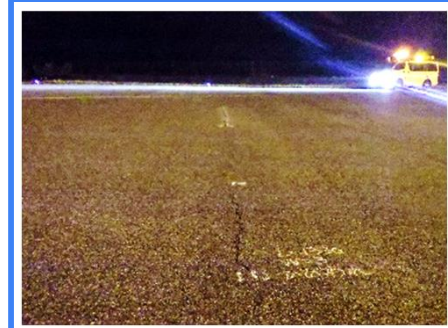
誘導路C10付近：ひび割れ
