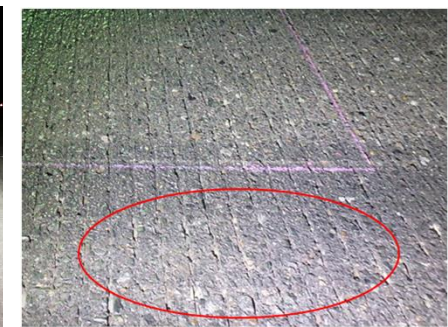
グルーピングの削れ・骨材の露出
