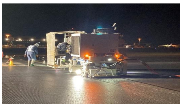
写真-5 グルーピング設置状況 (B 滑走路)
