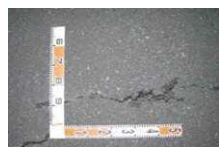
＜線状ひび割れ＞ 線状に入ったひび割れ
