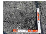
＜剥離＞ アスファルトの劣化、雨水浸透及び繰返し走行により生じたAs混合物の骨材とアスファルトとの剥がれ
