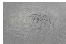
＜亀甲状ひび割れ＞ 線状ひび割れが進行し、網状に入るに至ったひび割れ
