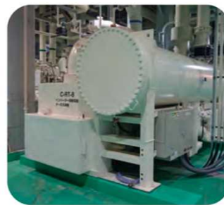
熱供給インバーターボ冷凍機
