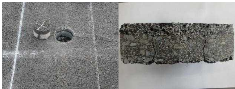
写真-11 コア採取・クラック確認 (クラック抑制シート部)
