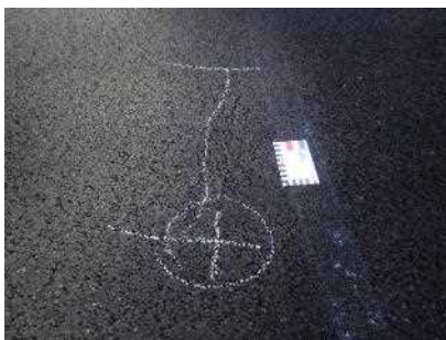
写真-10 ひび割れ状況
