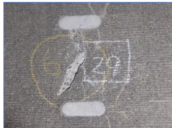
写真-3 版表層剥離状況
