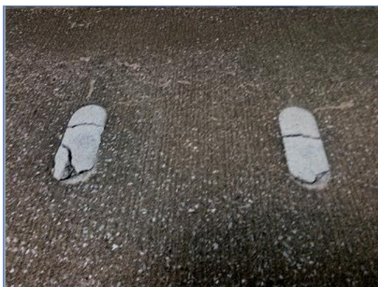
写真-2 H J蓋 破損状況
