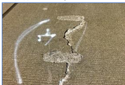
写真-9 表層剥離箇所
