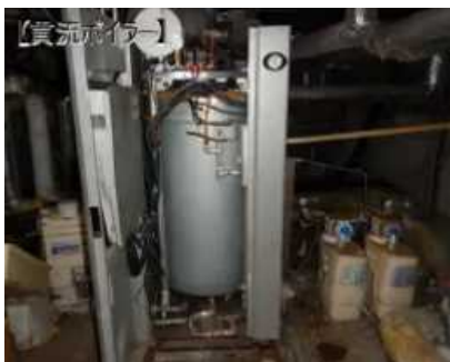
省エネ型ボイラー
