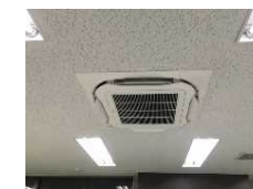
換気設備の導入
