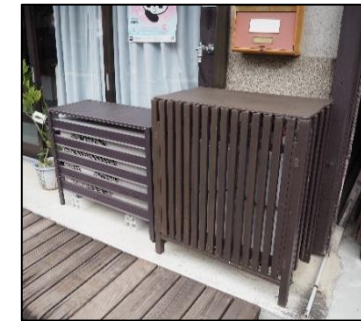
景観保全のためカーブで覆われた民家の室外機等。
