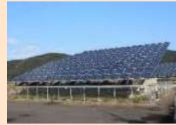
再エネ発電設備 など
