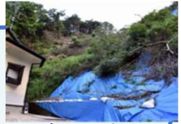
豪雨の度に 土砂崩れが多発
