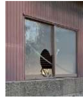
窓が割れた管理不全空家
