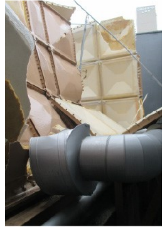
被災状況②
