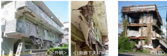
2階の廊下部分が崩落した事例
