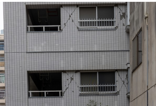
被災状況①
