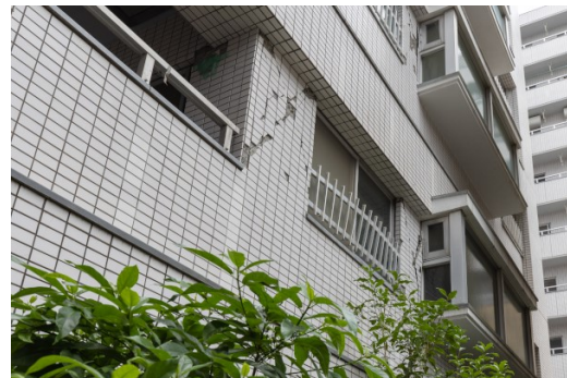
被災状況②
