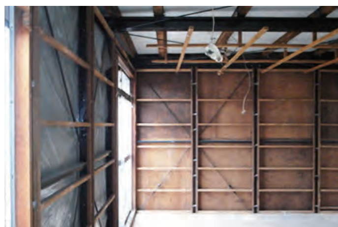
仕上げ材を撤去して、グラスウールを充填する前の状態
