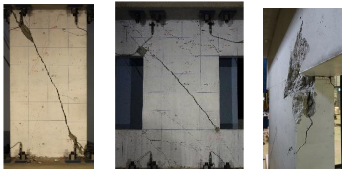
RC方立壁の損傷は激しく、せん断破壊となる。
