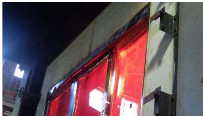
熱膨張による局所変形と隙間(大開口)
