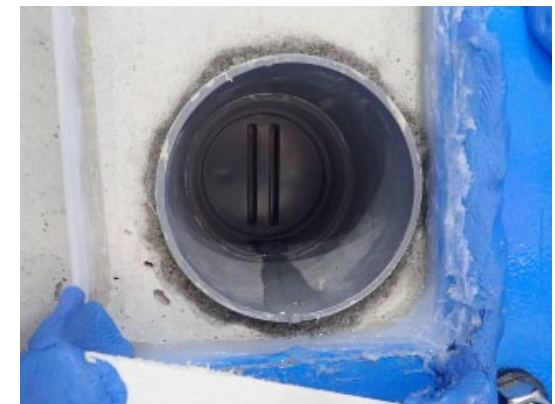
漏水状況の一例：水抜き穴
