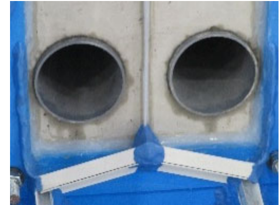
漏水状況の一例：スリーブ部 (RC-スリーブ間)
