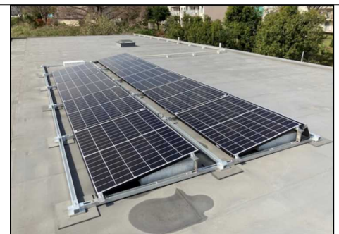
【屋上に設置した太陽光パネル】
