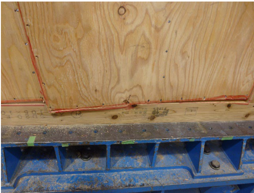
土台側の面材の踏み外し
