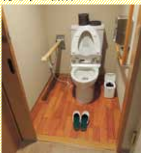
空調設備だった場所を活用 して広めのトイレ(手すり 付き)を新設しました
