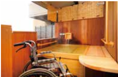
手すりと移乗台が設置された専用露天風呂
