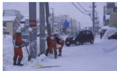
電柱の周辺は人力で除雪するため 作業効率低下（稚内市 国道40号）
