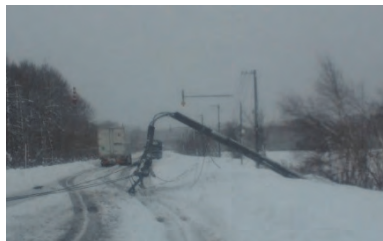
暴風雪による電柱の倒壊 （大樹町 国道336号）
