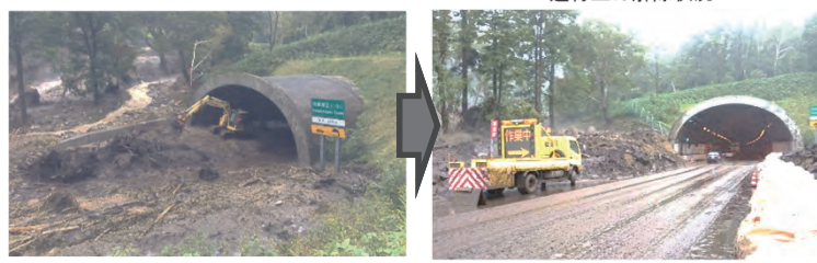
被災状況 通行止め解除状況
