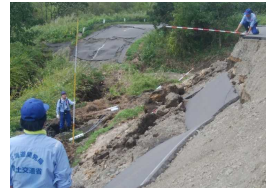
H30 北海道胆振東部地震被災状況調査(北海道厚真町)
