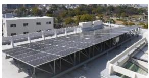
太陽光発電設備
