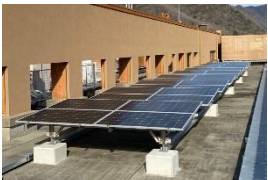
屋上に設置した太陽光発電設備の一部
