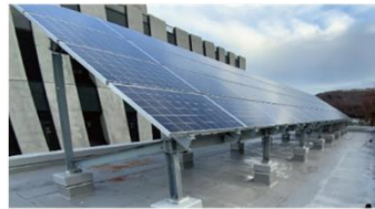
太陽光発電設備
