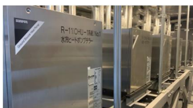
地中熱ヒートポンプチラー
