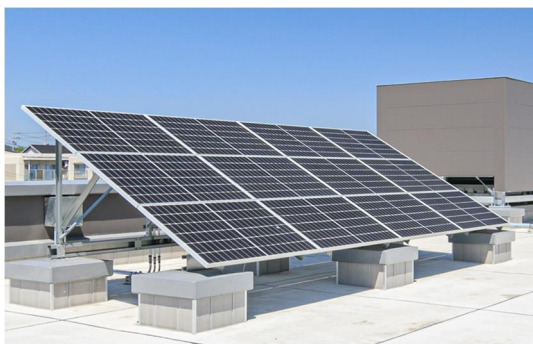
写真3 太陽光発電設備
