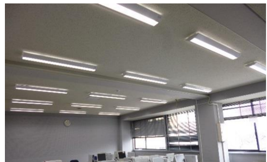
写真2 LED照明器具
