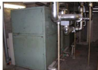
空気調和機劣化状況
