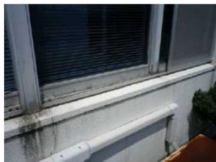
建具劣化状況
