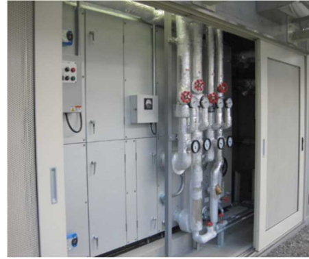
1階機械室（地中熱利用・潜熱顕熱分離空調）
