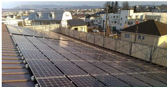
屋根 (太陽光パネル)
