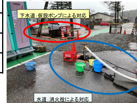
穴水町:仮設ポンプにより流下機能確保(下水道) 消火栓使用により避難所へ給水(水道)
