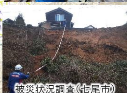
被災状況調査(七尾市)
