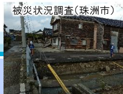
被災状況調査(珠洲市)
