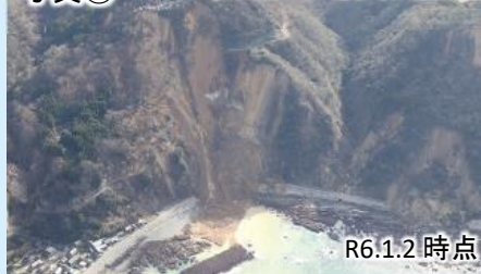
写真③ 国道249号法面崩落
