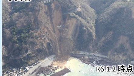
写真③ 国道249号法面崩落
