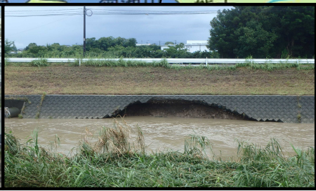
(護岸の損傷:緊急復旧中)
