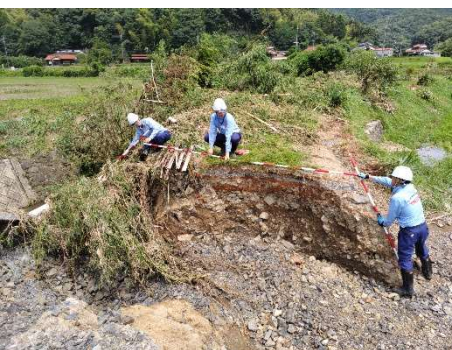
河川の被災状況調査(山口県美祢市)
