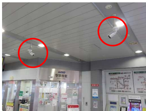
駅構内防犯カメラ
