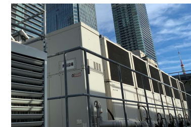
屋上の省エネ設備
