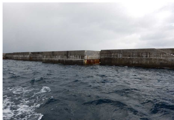
ケーソンの港内側への滑動
