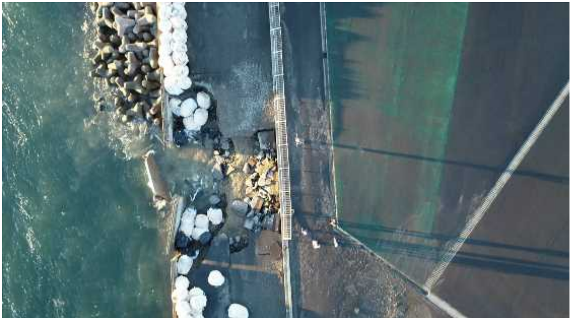
図－3 金沢区福浦地区 消波工端部での土嚢の飛散状況
