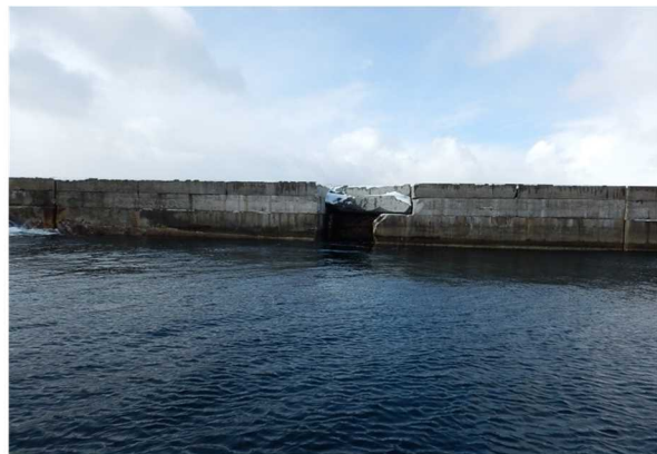
ケーソン・上部工の損壊
