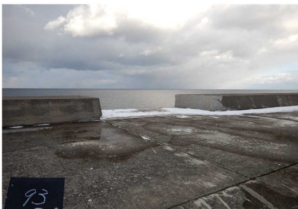
上部工の欠損
