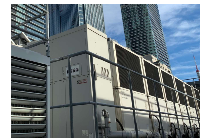
屋上の省エネ設備
