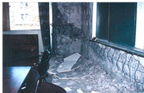
内部の被災状況
