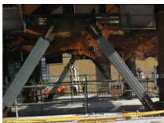
制震ブレース
