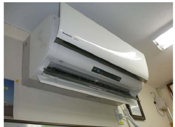
■ 蓄熱式エアコン (事務所内)
