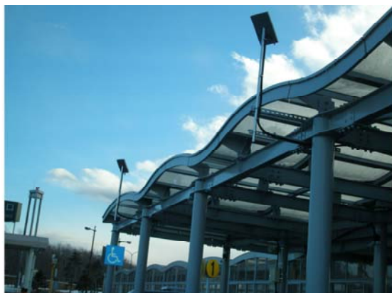
■ 太陽光発電 (身障者用駐車スペース)
