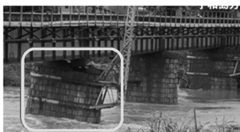
平成30年7月豪雨により被災した橋脚 (JR予讃線 財田川橋りょう)
