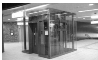
エレベーター
