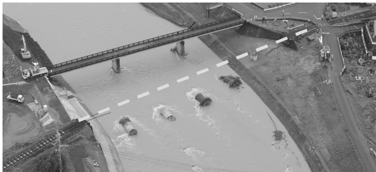
九州北部豪雨によるJR九州久大線花月川橋りょうの被災状況
