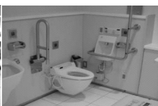
障害者対応型トイレ
