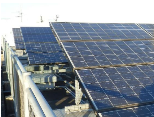
■太陽光パネル [空港事務所屋上]
