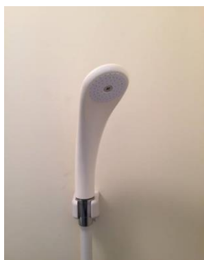
■節水型シャワールの活用 [燃料供給施設事務所内]
