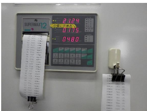
■ 供給電力の監視 [空港ビル内]
