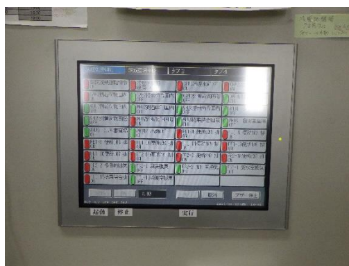
■ 供給電力の制御モニター [空港ビル内]
