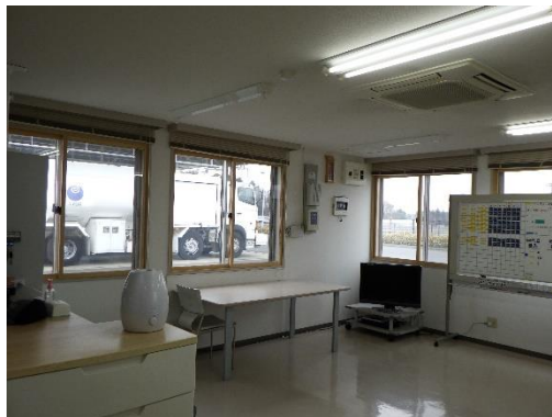
■照明の間引き [燃料供給施設事務所内]
