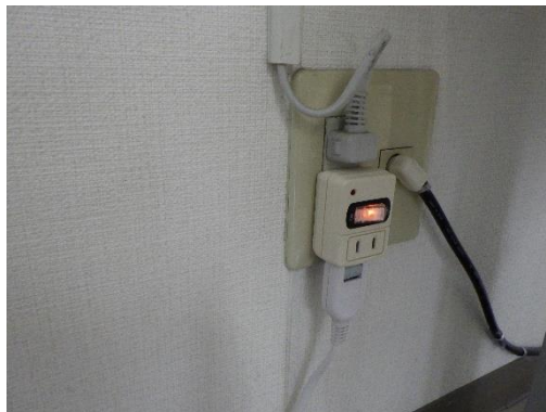
■省エネ型タップの利用 [燃料供給施設事務所内]
