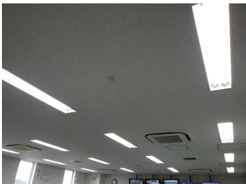
■LED 照明 [空港ビル内]
