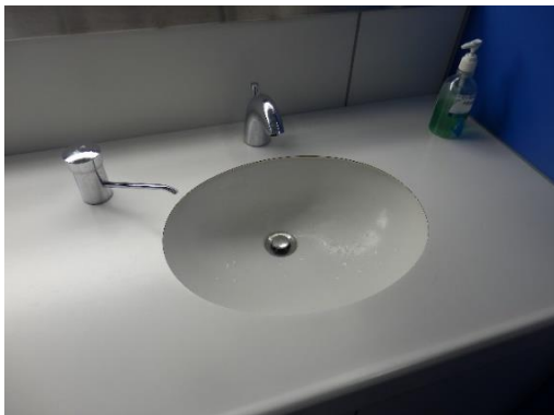
■自動水栓の導入 [空港事務所内]
