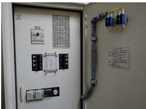
■ 照明点灯タイマー [公園施設トイレ内]
