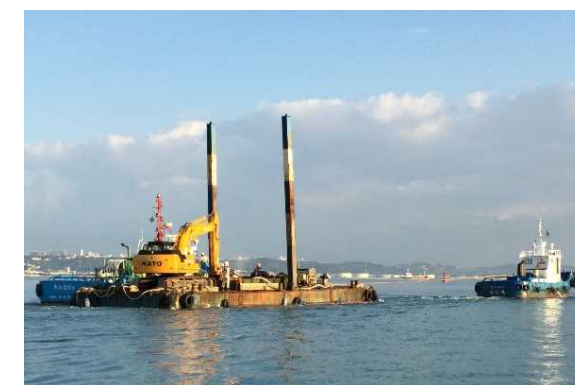
バックホウ台船 (曳船2隻体制で曳航) ※曳航時の留意事項はP7参照
