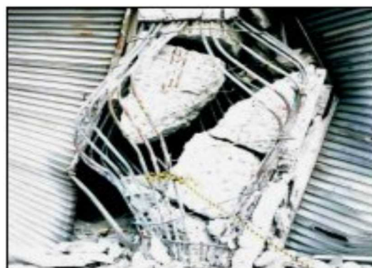
店舗1階柱の圧壊
