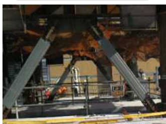
制震ブレース
