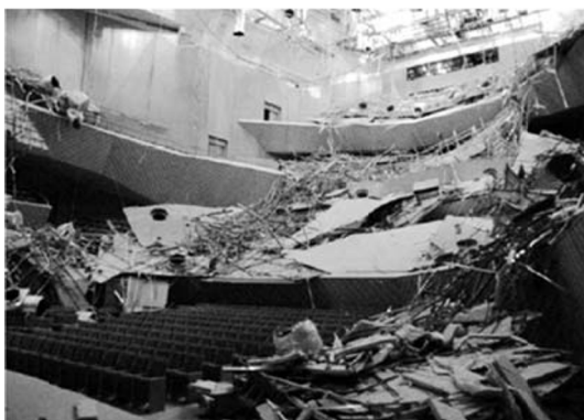
ホール天井の脱落
