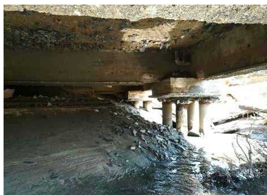
建物基礎が露出
